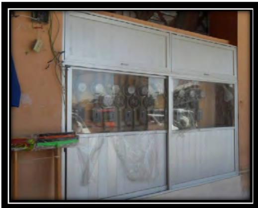
Fig. 13. Medidores de consumo de los locatarios y pasillos municipales. (Ubicados del estacionamiento).
