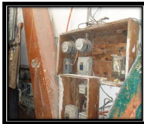
Fig. 16. Medidores de consumo antiguos y en mal estado instalados dentro del mercado en el área de ropa.
