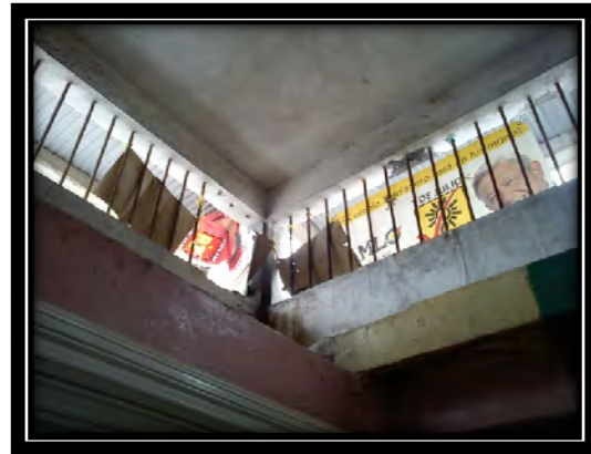
Fig. 42. Techo pasillo 1 con lonas.
