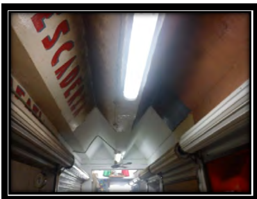
Fig. 9. Alumbrado instalado en el área de marisquería.
