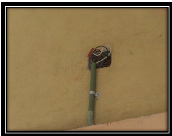
Fig. 28. Registro eléctrico ubicado en el pasillo exterior del mercado.
