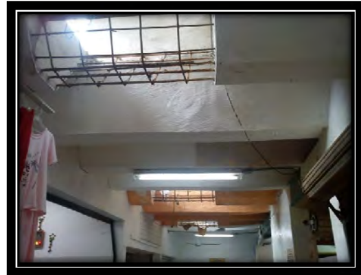
Fig. 12. Traga luz inventado instalado en el techo del área de marisquería y lonchería.
