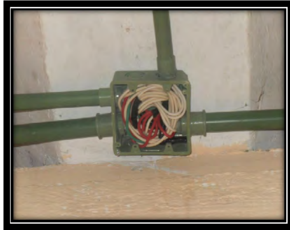
Fig. 30. Registro eléctrico ubicado en la parte superior del área de ropas.
