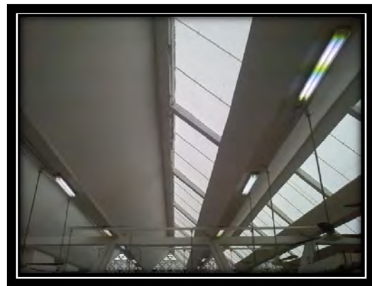
Fig. 6. Techo remodelado en el área de lonchería y ropa con láminas de policarbonato.
