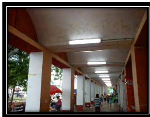
Fig. 8 Alumbrado instalado en el área de pasillos exteriores del mercado, encendidos a plena luz del día.
