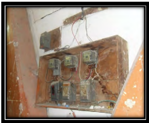
Fig. 15. Medidores de consumo antiguos y en mal estado instalados dentro del mercado cerca de los baños públicos.
