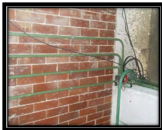
Fig. 27. Registro y cables no identificados de bajo de los medidores del mercado.
