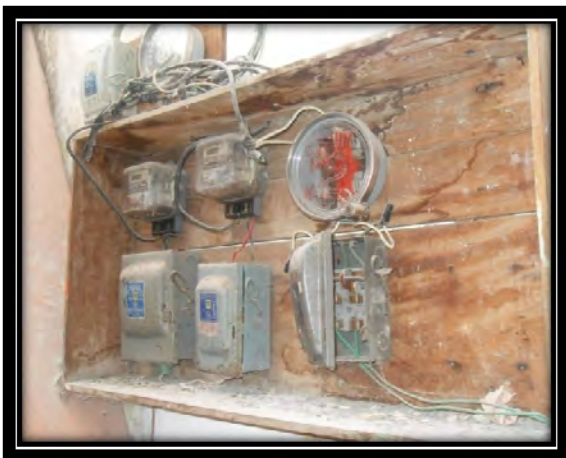
Fig. 22. Base de centros de carga y medidores ubicados en el interior del mercado el cual es inflamable.
